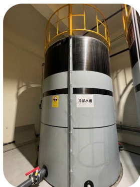
▲ 冷卻水塔廢水回收
